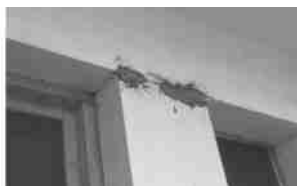
图11 小墙肢水平裂缝
