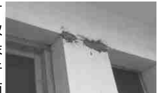
图11 小墙肢水平裂缝
