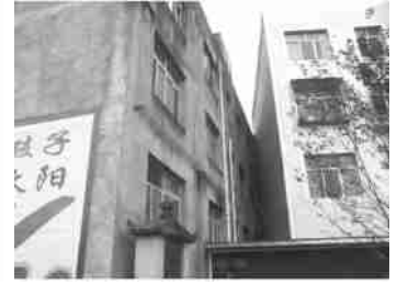
图10 建筑物间没有防震缝宽度
