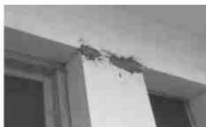
图11 小墙肢水平裂缝
