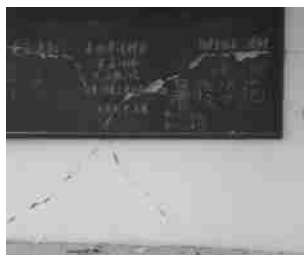
图9 教学楼横墙裂缝 (彭州市通济中学)
