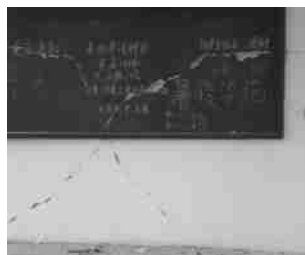
图9 教学楼横墙裂缝 (彭州市通济中学)
