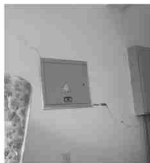
图 15 配电箱附近墙体震害 (彭州市梓桐小学)
