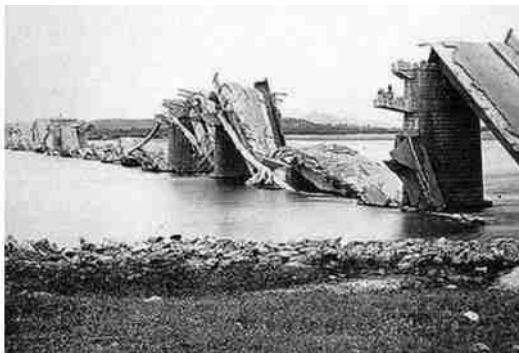
图2 落梁等上部结构破坏
