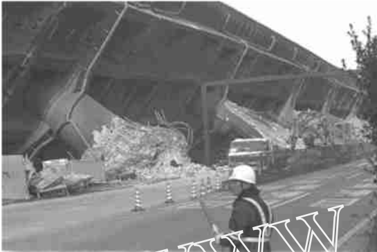
图1 桥墩塑性铰破坏
