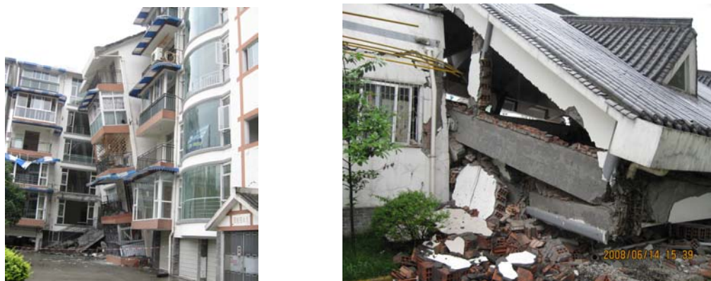
图 5 汶川地震中因柱铰机制倒塌的框架结构
