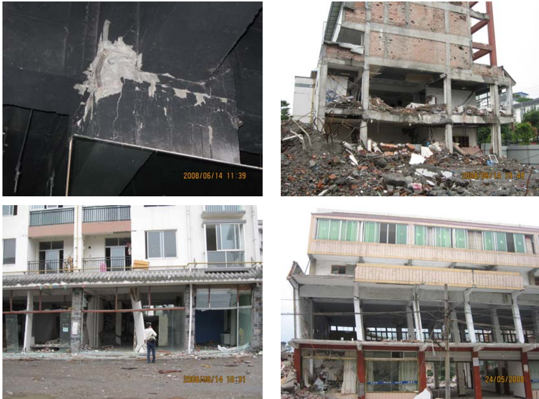
图 1 汶川地震中框架结构的柱铰破坏机制
