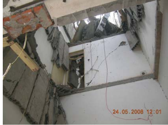
图4 安县秀水镇广电楼出屋面信号塔砸穿西侧两个开间造成三人死亡
