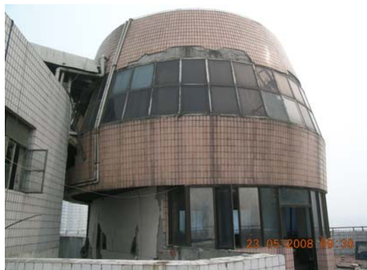
图2 绵阳商场12层出屋面圆形会议室破坏
