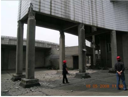
图3 绵阳财政大厦出屋面装饰小楼严重破坏
