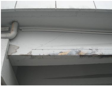
图 21 混凝土 T 梁腹板扭转裂缝
