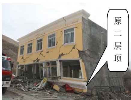
照片 10 底层倒塌二层侧移并扭转
