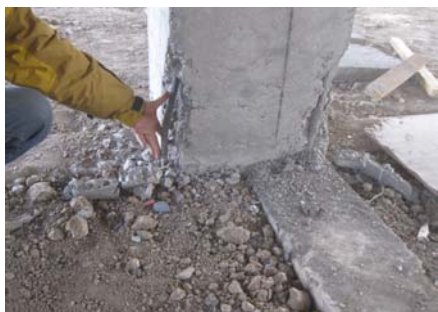
照片 3 框架柱根箍筋间距过大，主筋压曲
