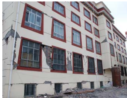
照片 8 康巴宾馆底层角柱柱端破坏
