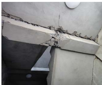
照片 13 州农发行楼梯梁破坏
