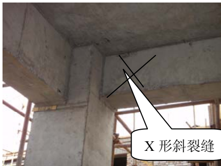
照片 5 框架边梁端“X”形斜裂缝
