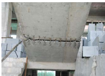
照片 12 州医院楼梯踏步板破坏,主筋压曲
