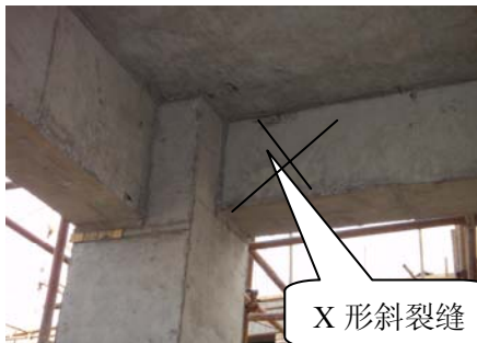
照片 5 框架边梁端“X”形斜裂缝
