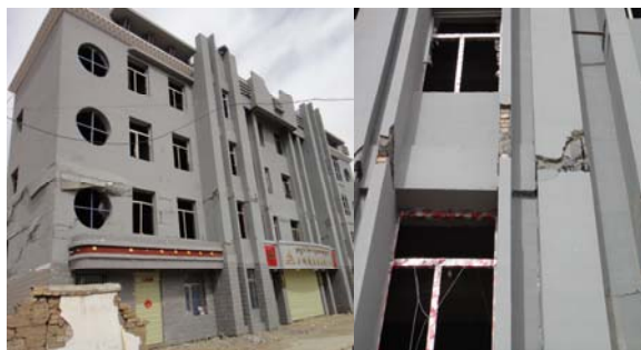
照片 6 州农业发展银行办公楼二层柱端混凝土酥碎主筋压曲
