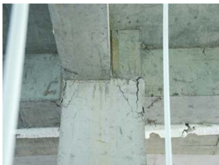
照片 4 底层柱端保护层混凝土压溃
