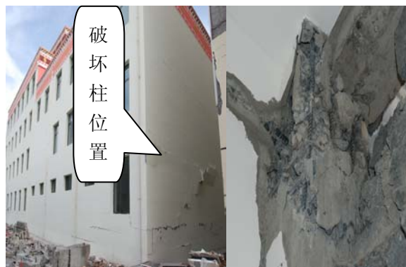
照片 7 州藏医院底层柱端砼酥碎、钢筋压曲
