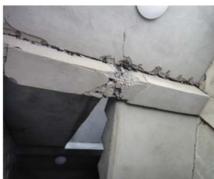
照片 13 州农发行楼梯梁破坏
