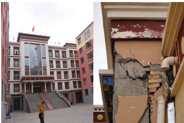
照片 9 州烟草专卖局办公楼底层梁柱节点破坏
