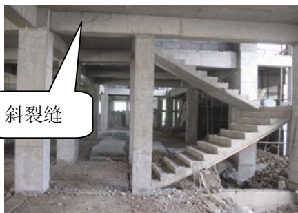
照片 11 州医院楼梯相邻框架梁端斜裂缝
