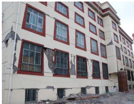
照片 8 康巴宾馆底层角柱柱端破坏
