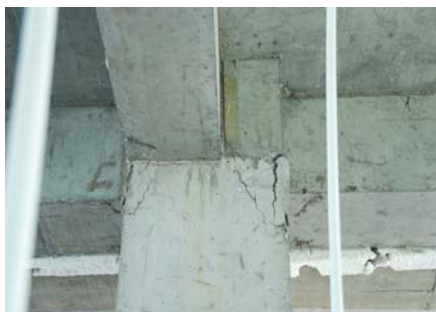
照片 4 底层柱端保护层混凝土压溃
